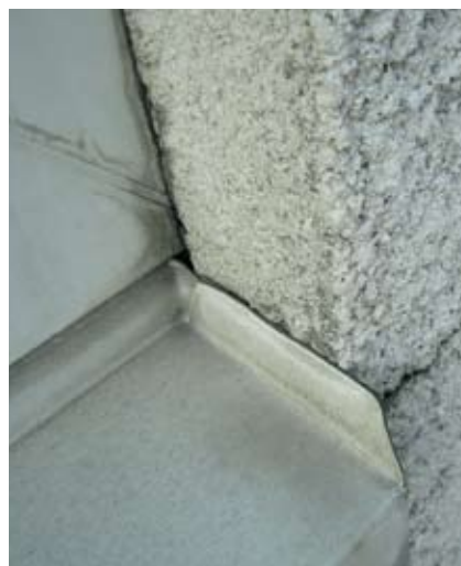
VIRHEELLINEN IKKUNAPELLITYS, JOSTA SADEVESI PÄÄSEE RAKENTEeseen.
