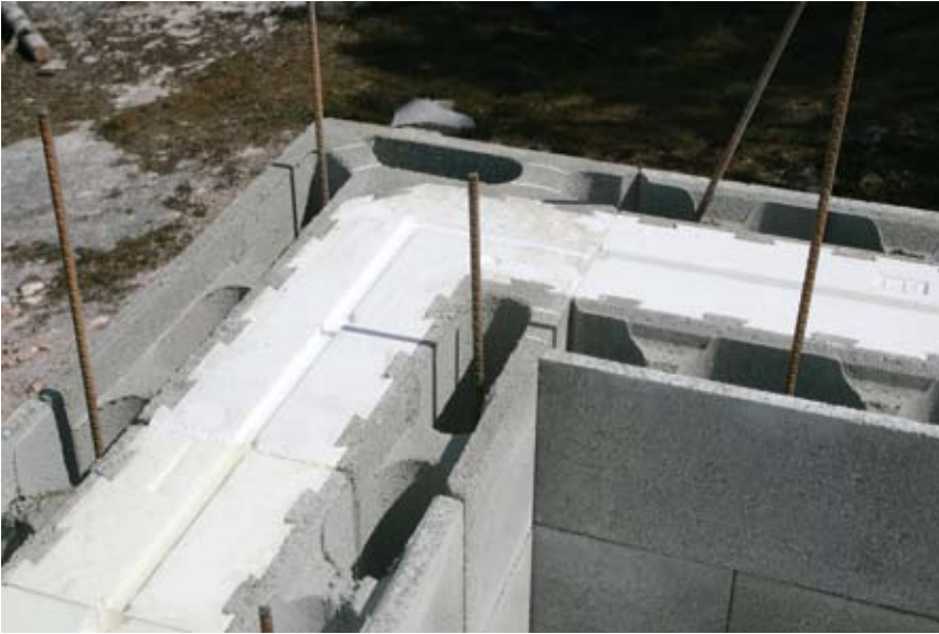
Kuva 2.12. Rakenteiden nurkat tehdään kulmaharkkoja käyttäen. Pystyraudoite asennetaan valuonteloihin ja vaakaraudoite kannaksen uraan.
