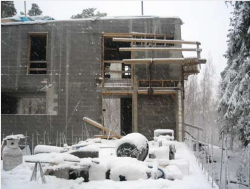
Kuva 4.18. Talvella tulee huolehtia riittävästä sääsuojauksesta, lämmityksestä ja liukkauden poistosta. Jäätynyt betoni ei saavuta suunniteltua lujuutta, joten jäätynyt rakenne joudutaan yleensä purkamaan. Purkamiskustannukset ovat moninkertaiset lämmittämiseen ja suojaukseen verrattuna.
