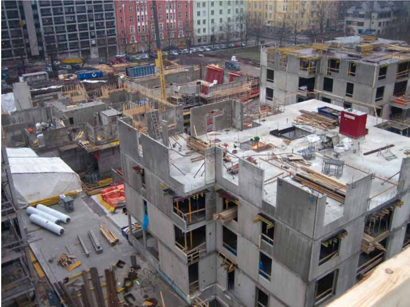
Paikallavaletut seinät, välipohjat ja yläpohja tuottavat rakennuksen asukkaille hyvän ääneneristävyyden kaikissa huoneistoissa.
