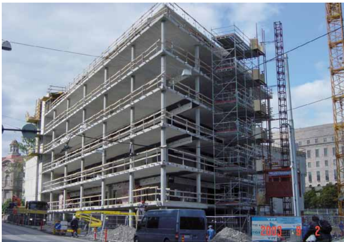
Kuva 2.14. Paikalla valettu pilarilaatta on maailman yleisin betonisten rakennusten runkojärjestelmä. Pilarilaatarunkoisen rakennuksen käyttötarkoitusta on helppo muunnella eri tarkoituksiin. Yli 250 mm paksu pilarilaatasto täyttää erilaisten rakennusten välipohjalle asetettavat ääneneristävyyksivaatimukset.
